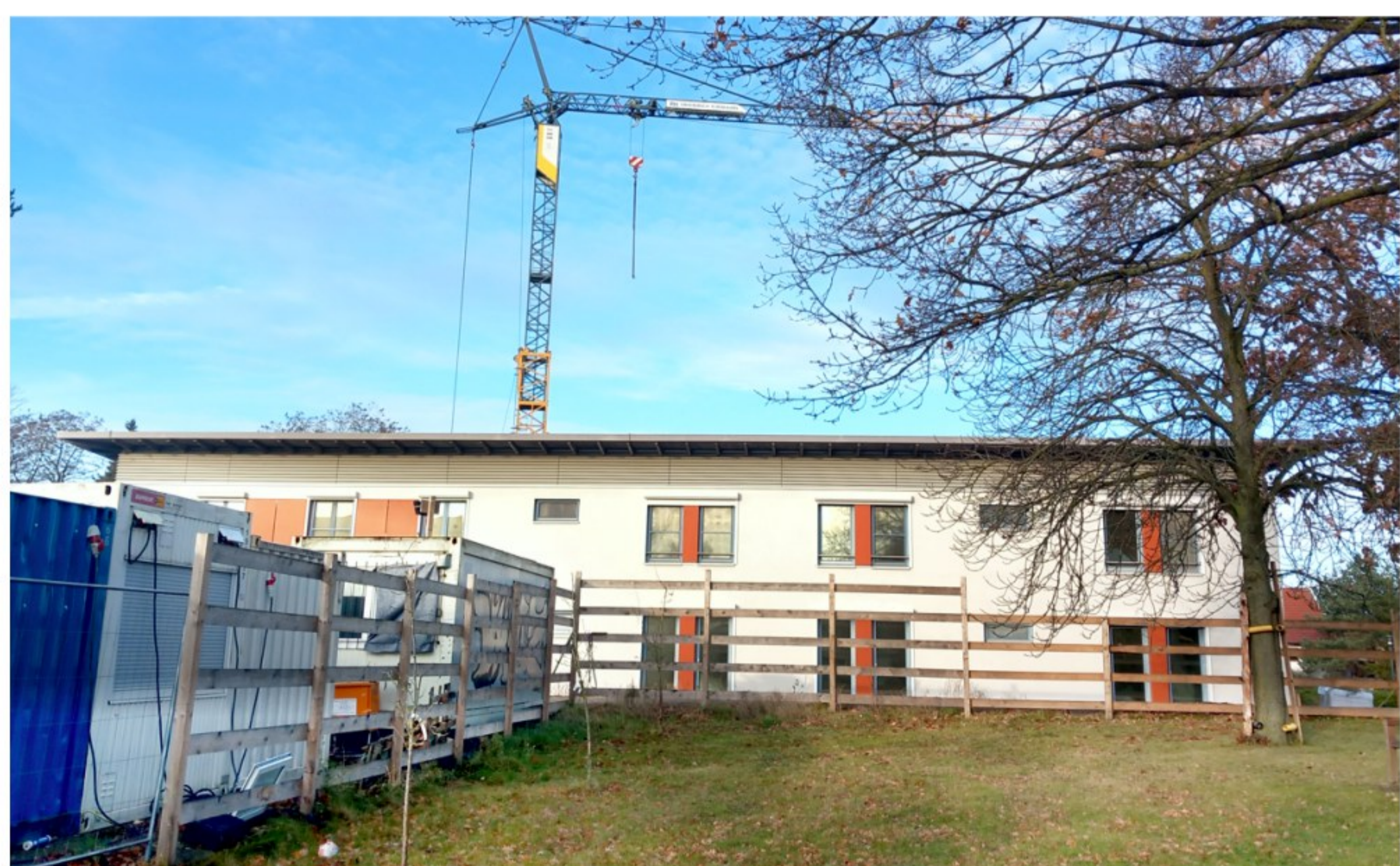
Der Ausbau des Bodelschwinghauses bietet künftig mehr Einzelzimmer für unsere Bewohner und erfüllt damit die gesetzlichen Anforderungen.
