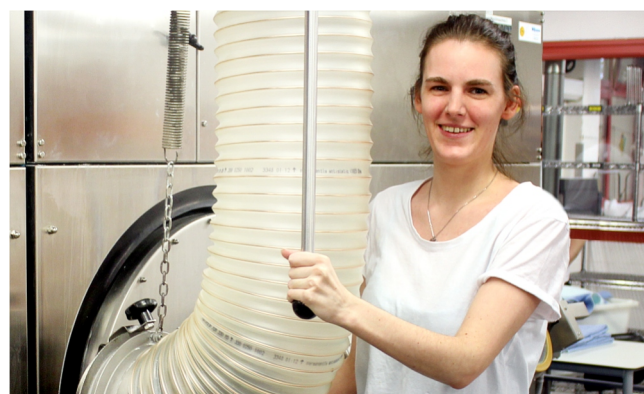
In der Wäscherei sorgt seit diesem Jahr eine Klimaanlage für angenehm kühlere Stunden.
