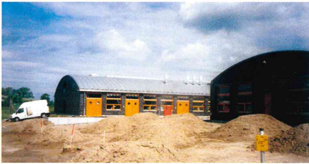
Im Gewerbegebiet Kröpelin-West entstanden in nur 15-monatiger Bauzeit die „Kröpeliner Werkstätten“ - eine großzügige und ansprechende Werkstatt für Behinderte. (Architekt: Dannien + Fendrich + Partner, Lübeck)
