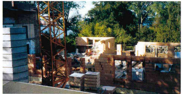
Das schöne Wetter im Oktober 1999 ermöglichte einen raschen Baufortschritt am neuen Karstenhaus.
